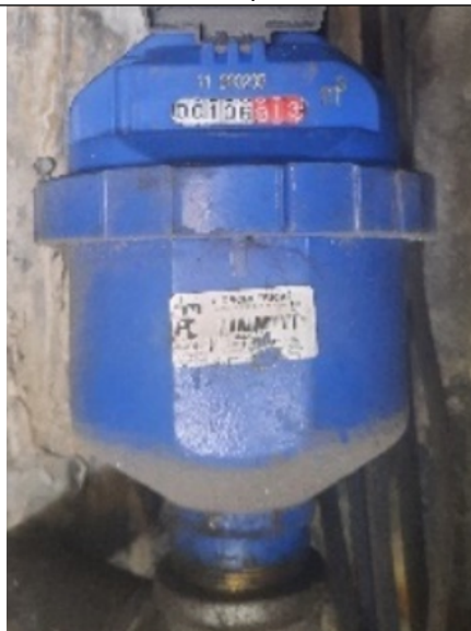
Foto No. 7 Medidor instalado
