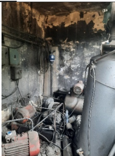
Foto No. 6 Cuarto de bombas
